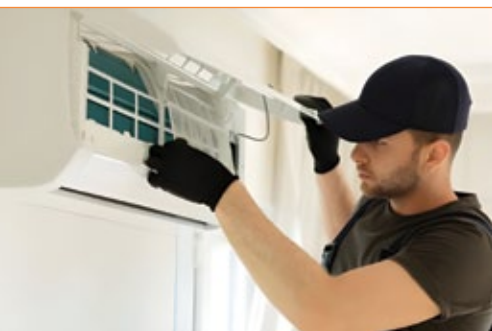
تنظيف المرشحات لجهاز التكييف
