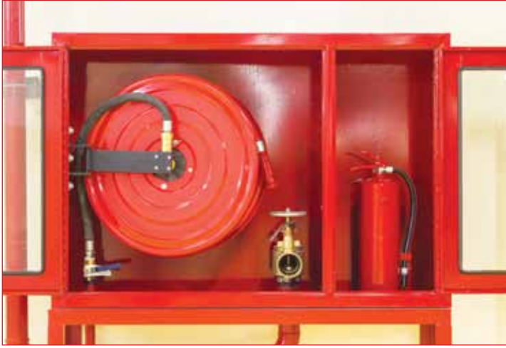
بعض معدات مكافحة الحريق
