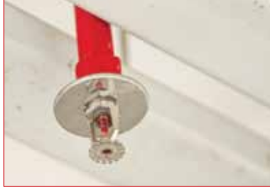
مرشات مكافحة الحريق
