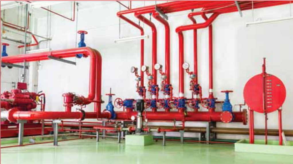
منظومة مياه مكافحة الحريق
